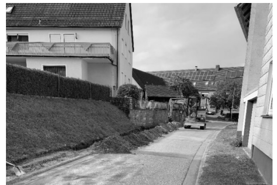
Mitte September 2020 rollten in Untermosbach die Bagger für die notwendigen Trassenarbeiten nach Matzmansdorf an. Foto: privat
